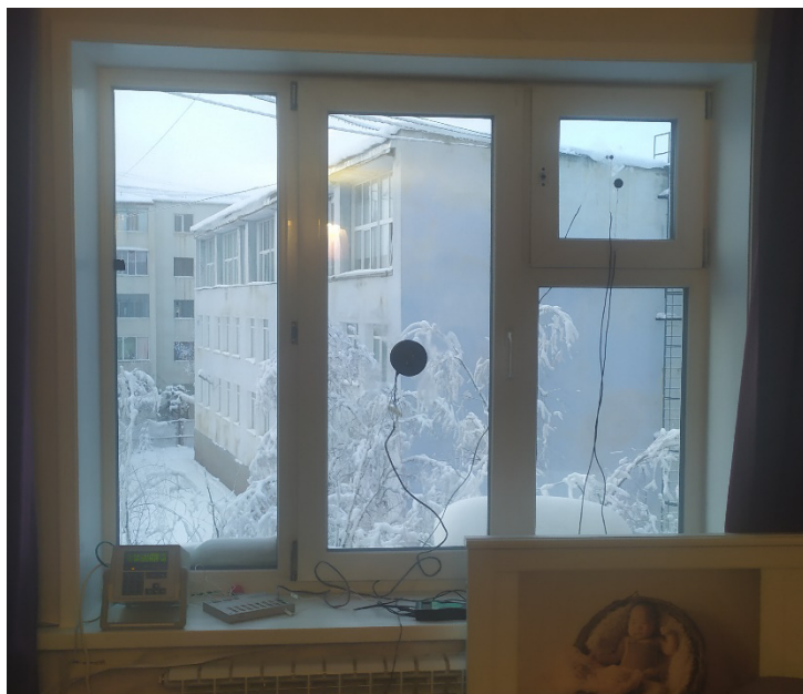
Рис. 8. Фото оконного блока с установленными датчиками
